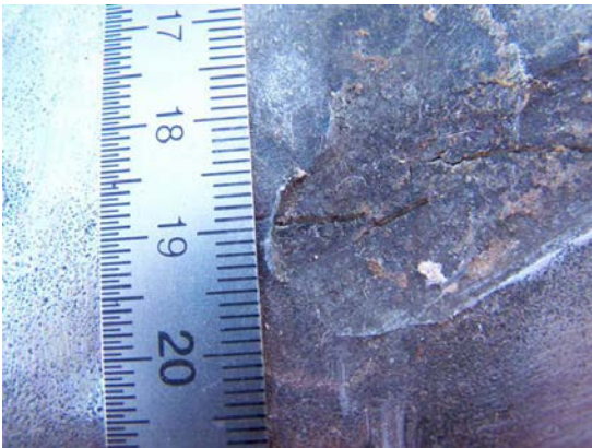
[fig.10] cricca in corrispondenza del difetto DG4B2
