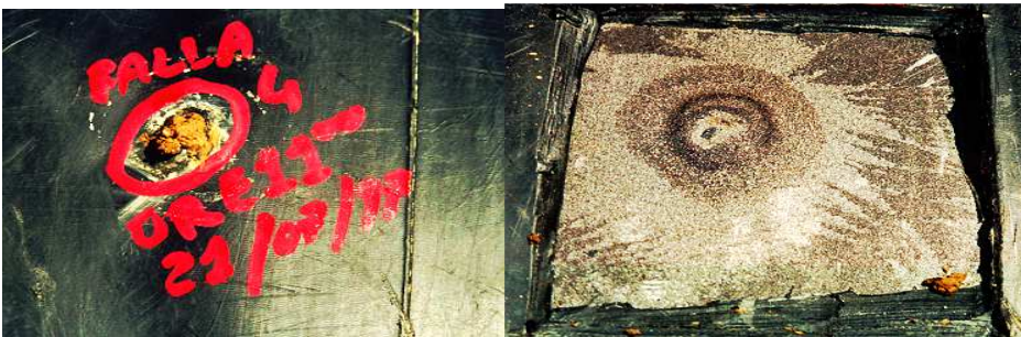
[fig.11] difetto nel polietilene causato da una bennata con area di 100 cm 2 con disbonding catodica
