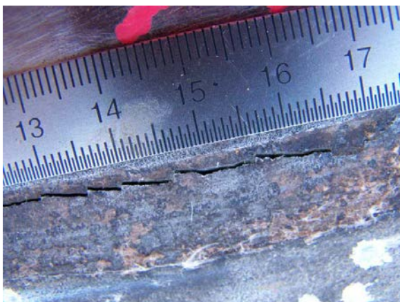
[fig.8] cricca in corrispondenza del difetto G2B1
