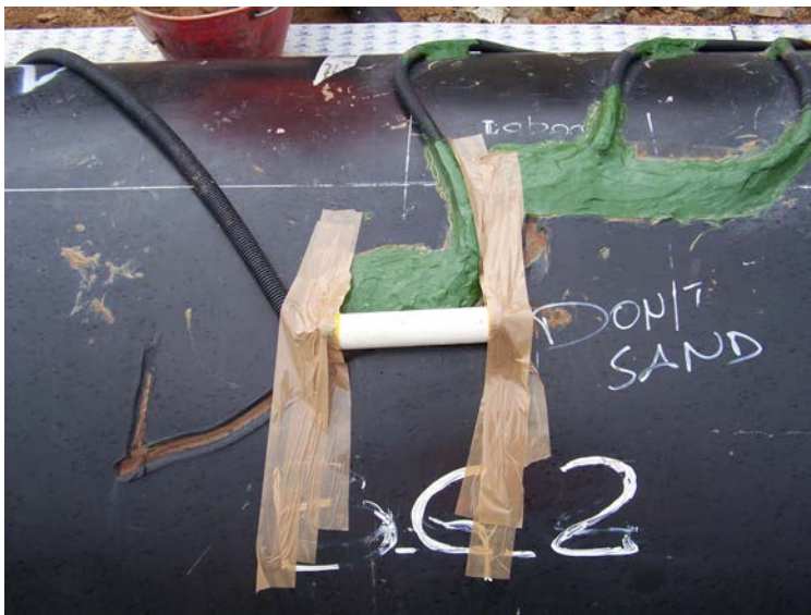
[fig.4] difetto nel rivestimento e posa elettrodo di riferimento fisso
