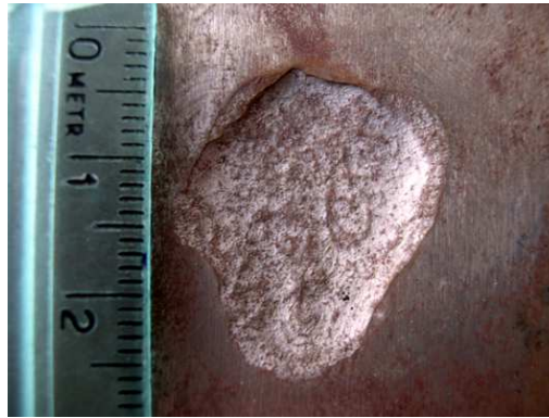
[fig.7] Esempio di corrosione da corrente alternata riscontrata su provino
